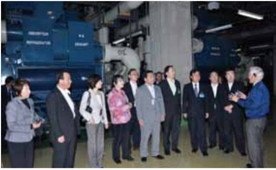
6月2日 超高層オフィスビル「六本木ヒルズ森タワー」。日常的に周辺施設へ電気や熱を供給している独自施設などを視察するとともに、3月11日の東日本大震災当日、帰宅困難者を施設内に受け入れた際、約1500人分の飲料水や非常食、毛布を配布した状況を聞く。
