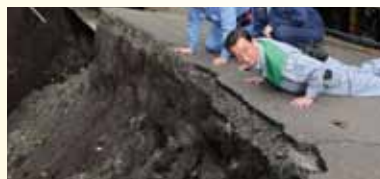
泉津地区の道路崩落現場を調査。
